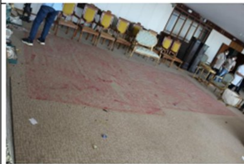
Salão Nobre com carpete manchado e encharcado
